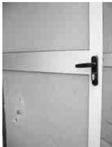
UNA PORTA DANNEGGIATA
